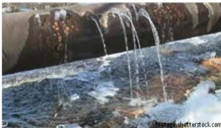
Ryc. 2. Przykład wycieków z sieci wodociągowej.
